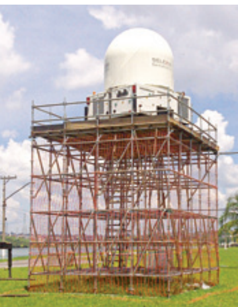
Radar do Projeto CHUVA instalado nas dependências da Empresa Metropolitana de Águas e Energia (EMAE)
